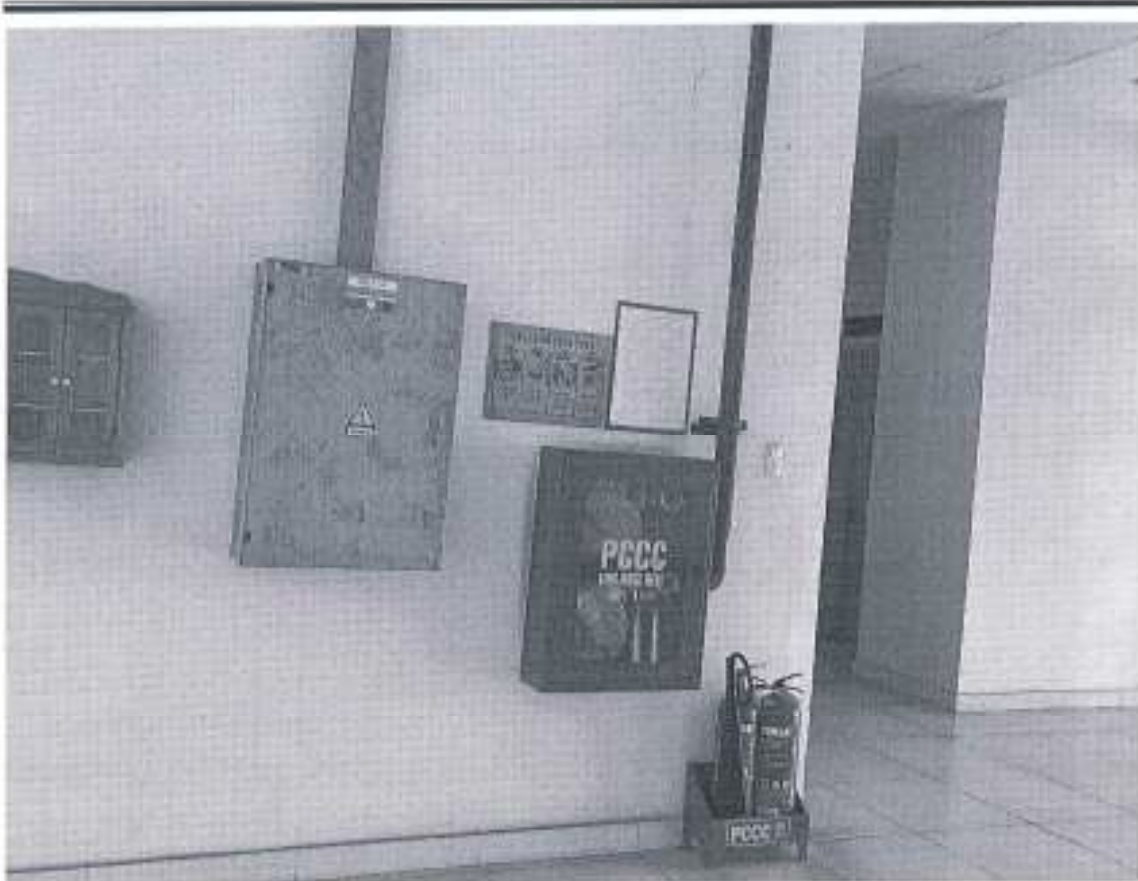
Hình 1. 6: Hệ thống PCCC tại cơ sở
