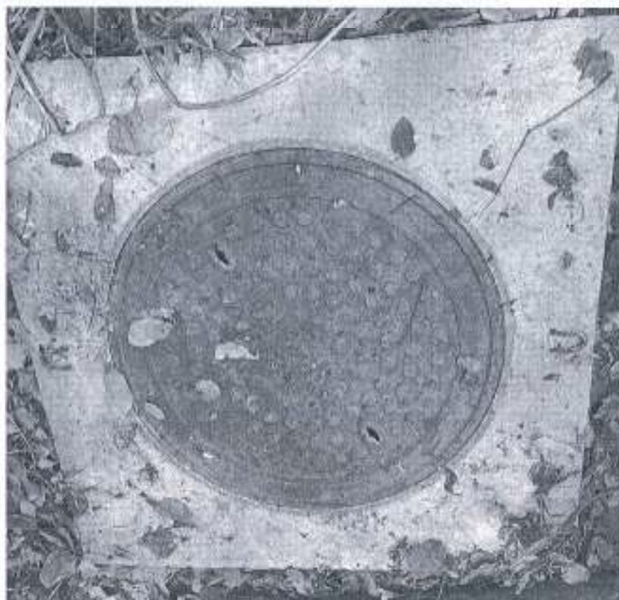
Hình 3. 4: Điểm đầu nổi nước thải trên đường D1
