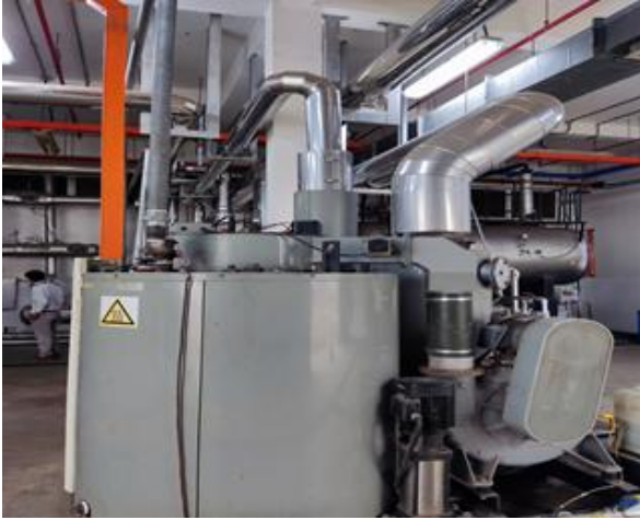
Hình ảnh lò hơi đốt dầu DO 1,5 tấn/h
