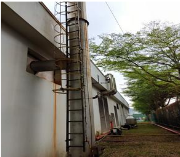
Hình ảnh ống khói lò hơi 4 tấn/h
