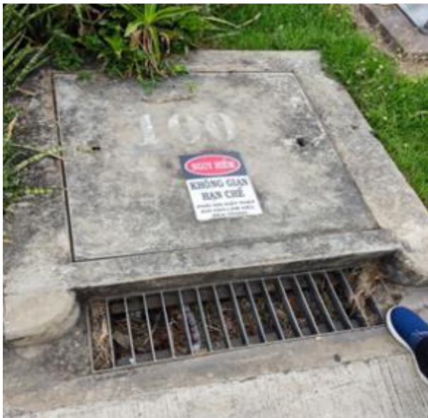
(Cống thu gom nước mưa tại nhà máy)
