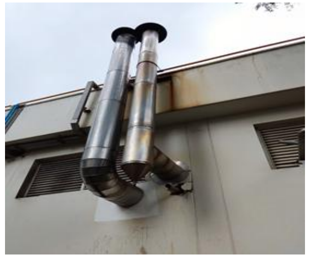
Hình ảnh 2 ống khói lò hơi 1,5 tấn/h
