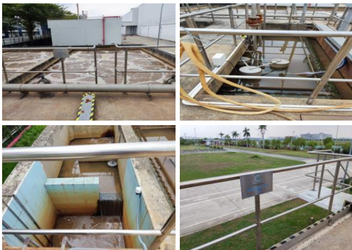
Hình 3.8: Hệ thống xử lý nước thải công suất 200 m 3 /ngày.đêm
