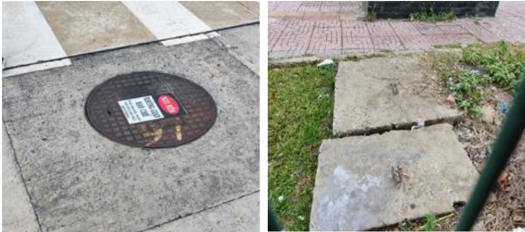
(Cống thu gom nước thải tại nhà máy) (Cống đấu nối nước thải vào hệ thống thu gom nước thải KCNC)
