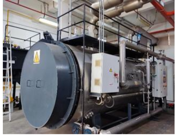
Hình ảnh lò hơi đốt dầu DO 4 tấn/h
