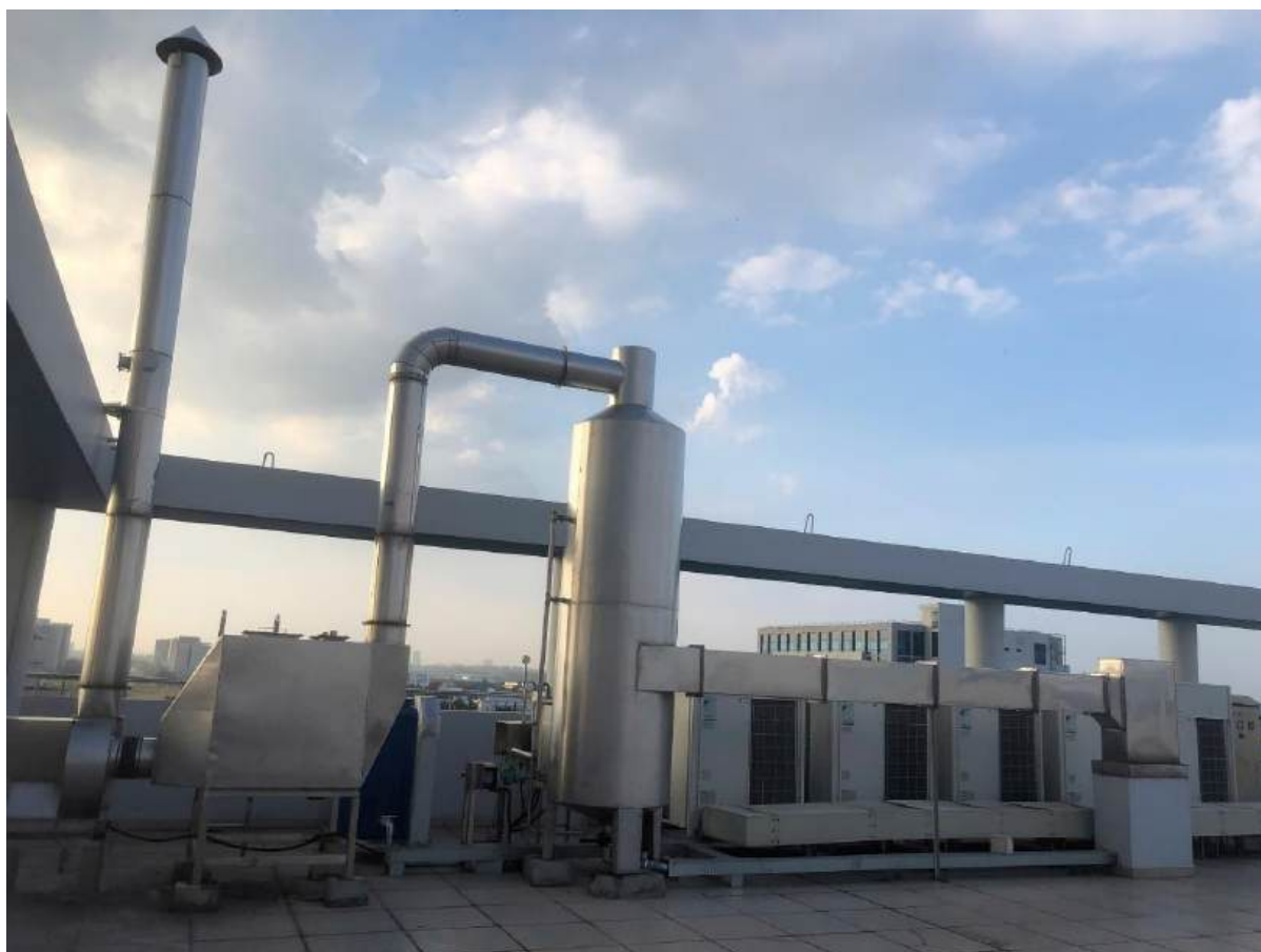
Hình 3. 16: Hình ảnh hệ thống xử lý khí thải từ tủ hút của các phòng thí nghiệm.
