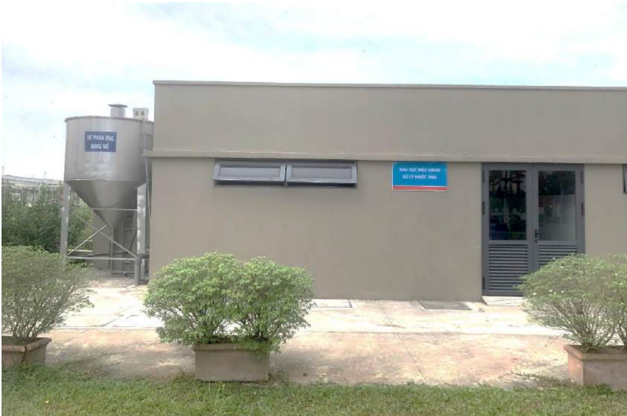
Hình 3. 13: Hình ảnh toàn cảnh trạm xử lý nước thải công nghệ, công suất 20 m 3 /ngày đêm đã được xây dựng.
