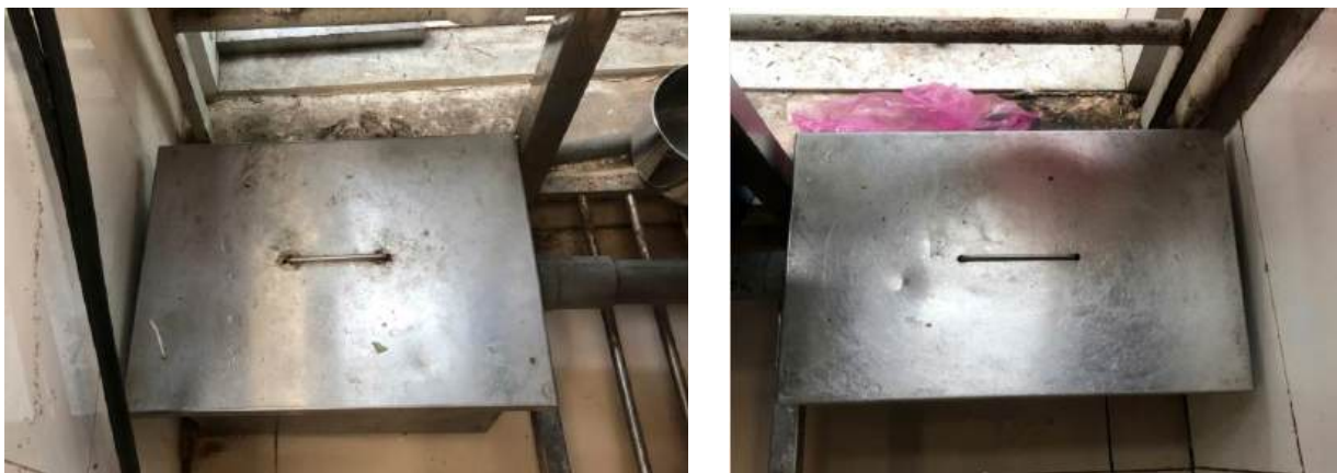
Hình 3. 10: Hình ảnh 02 bể tách dầu mỡ tại cơ sở.
