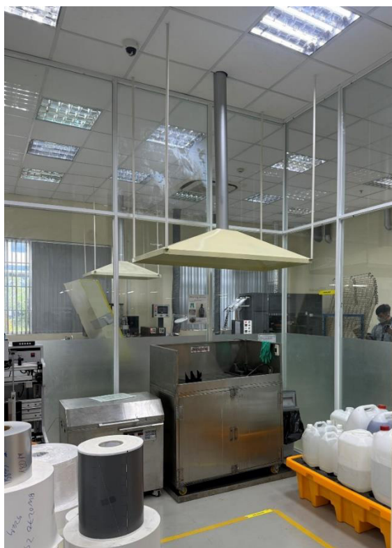
Hình 3.19 Đường ống thu gom khí thải phát sinh từ khu vực rửa mực in HP
