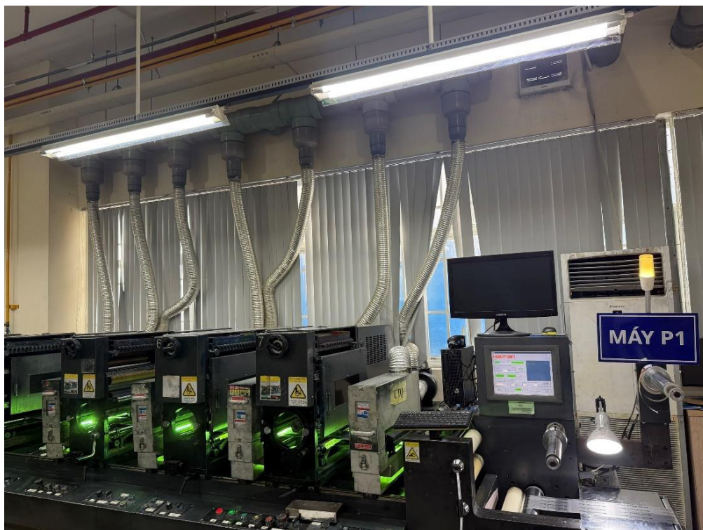
Hình 3.12 Đường ống thu gom khí thải phát sinh từ máy in LP 7 màu
