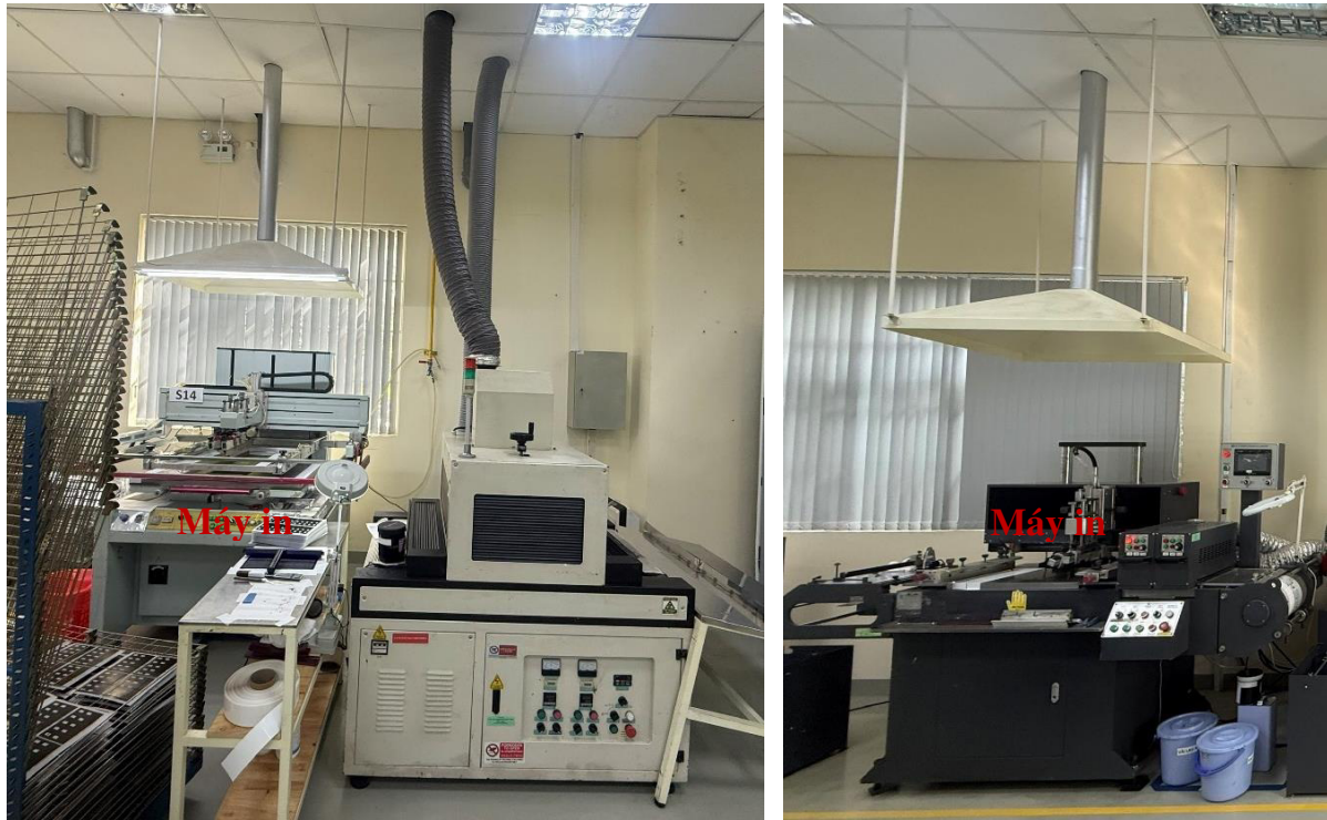
Hình 3.14 Đường ống thu gom khí thải phát sinh từ 02 máy in lưới công nghiệp
