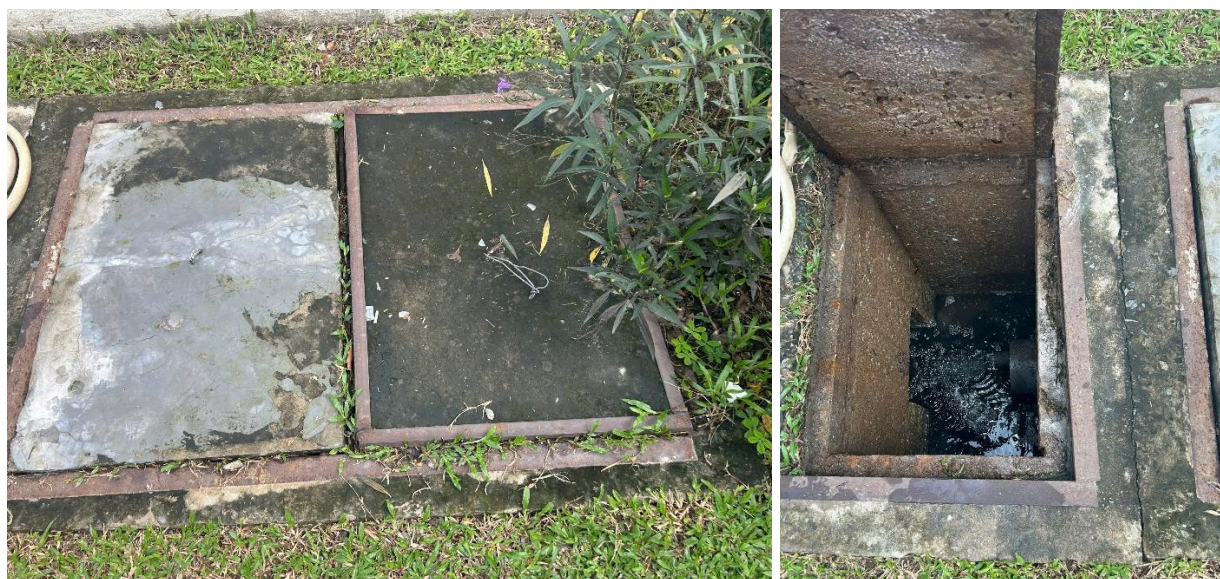
Hình 3.4 Hố ga nước thải
