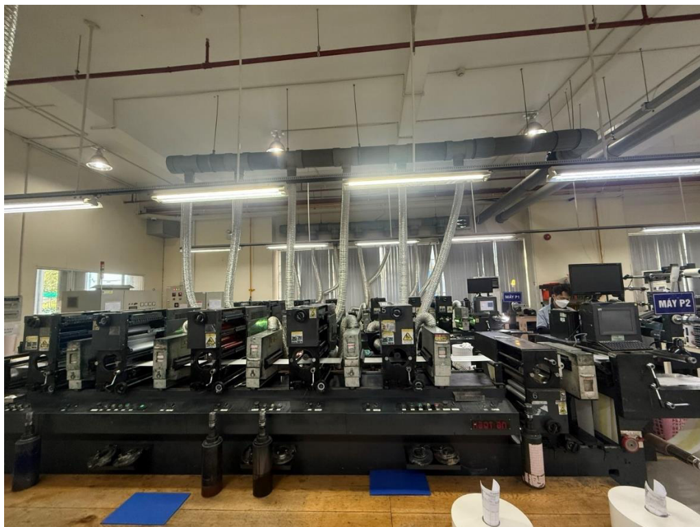
Hình 3.11 Đường ống thu gom khí thải phát sinh từ máy in LP 5 màu
