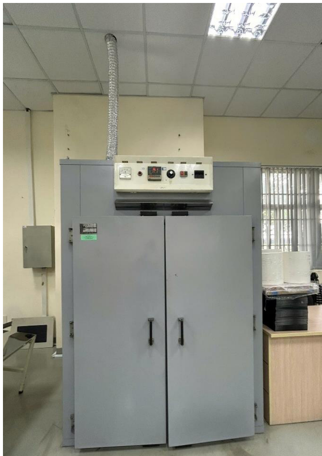
Hình 3.16 Đường ống thu gom khí thải phát sinh từ lò sấy nguyên khung của công nghệ in lưới công nghiệp
